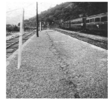
大安(泰安)火車站月台上之龜裂線
